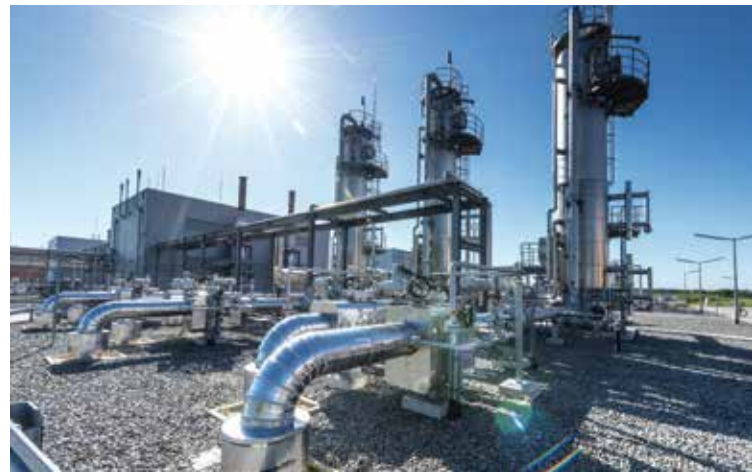
Brandschutzboxen ENERGY Firecover® in einer Gasspeicheranlage
