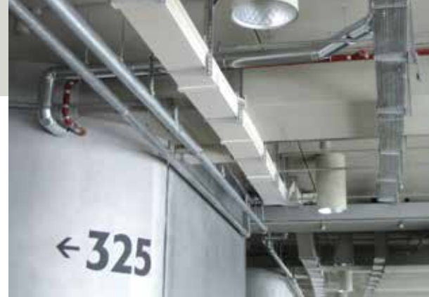
Brandschutzkanal Klasse Igo in einem Sportstadion
